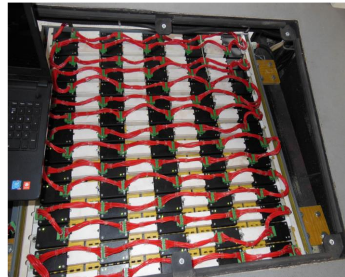
Sistemul de monitorizare a bateriei de acumulatori
